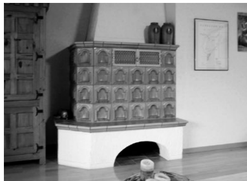
So sah es vor dem Ofentausch aus: Ein klassischer Kachelofen sorgte für die Wärme.
